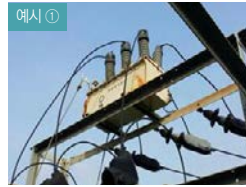
ASS 상태 확인(외부용) * H변대에 올라가서 확인하지 마십시오.
